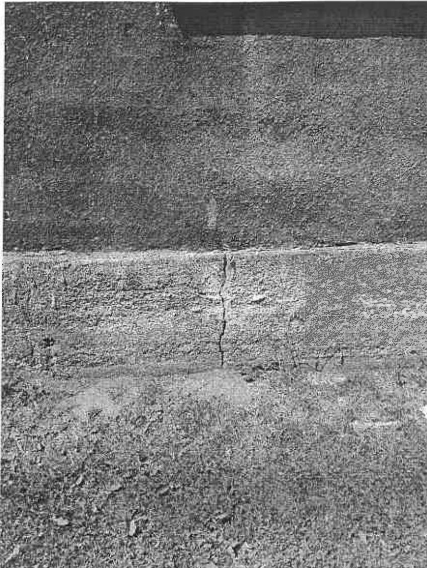
Elewacja wschodnia – widoczne pęknięcia (zamontować plomby)
