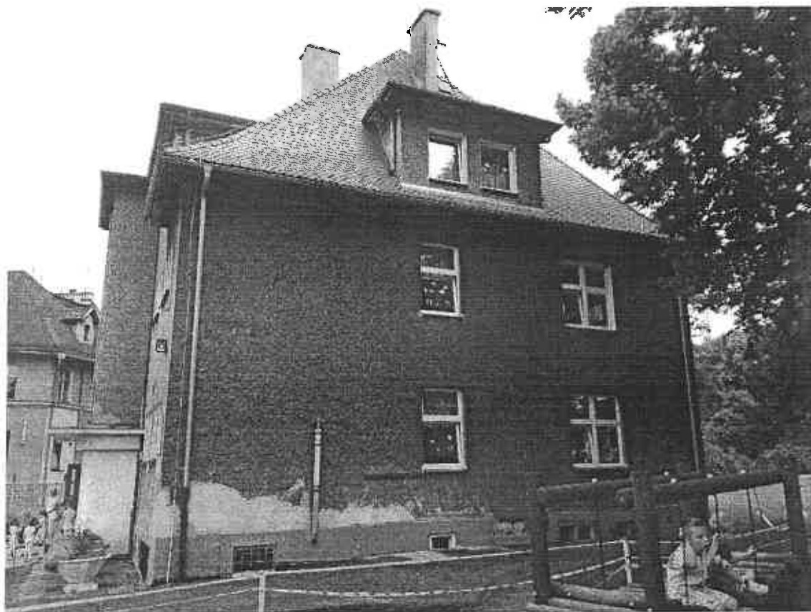
Elewacja południowa – widoczne pęknięcie naroża budynku. Rura spustowa.
