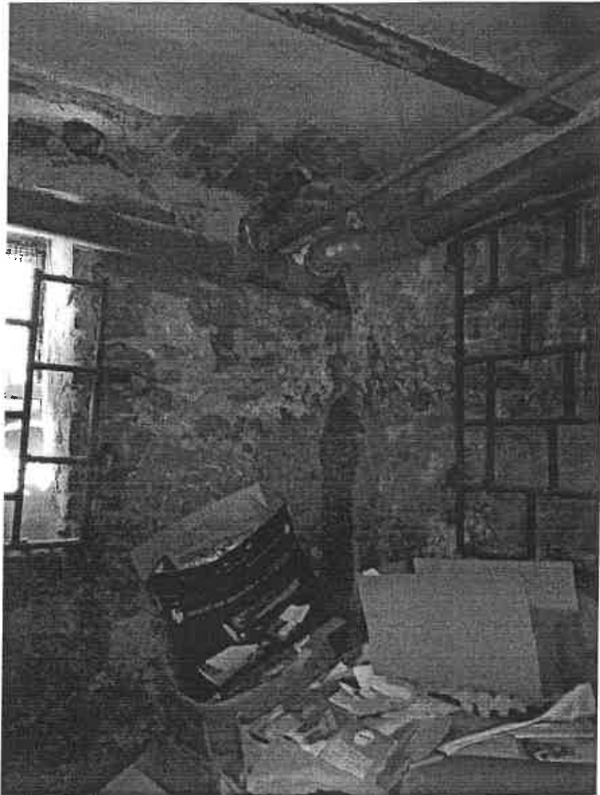
Pomieszczenie piwniczne – zmurzałe tynki, pion kanalizacyjny (sanitarny i deszczowy)
